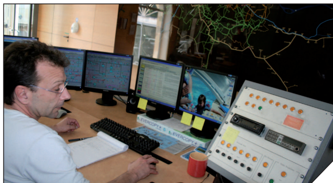
Le centre de télécontrôle de la Lyonnaise des Eaux-Suez à Bordeaux. © AEC
